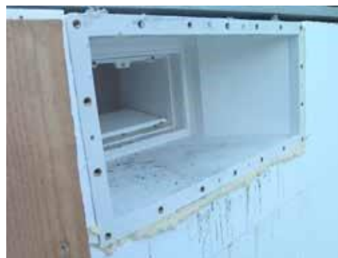
▼ Fertig eingeschäumte WH-Skimmer
