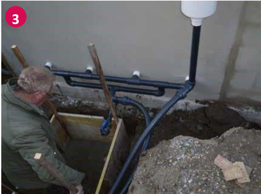
▼ Verrohrung von Düsen, Skimmer und Bodenablauf
